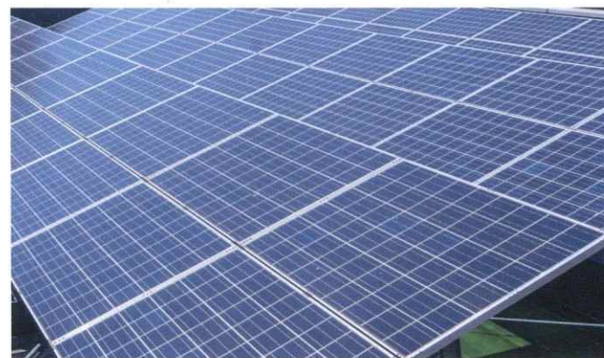
太陽光パネル
