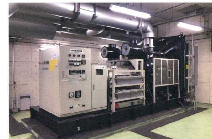
非常用発電機
