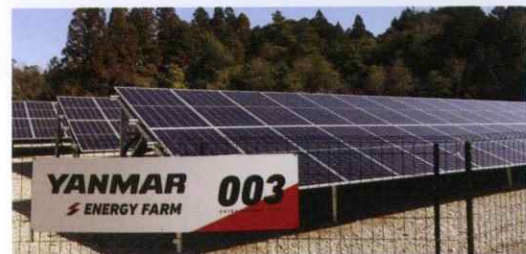
ヤンマーの発電所に設置した太陽光発電設備(琵琶湖カントリー倶楽部様)
