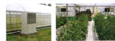
園芸用GHP室外機 園芸用GHPを設置したハウス内
