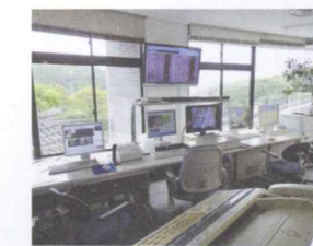
ダム管理用制御処理設備、CCTV監視設備 <茨城県飯田ダム>
