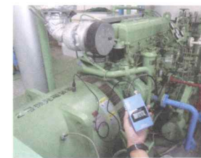
機械設備の新たな傾向管理手法 <国土交通省関東地方整備局 関東技術事務所>
