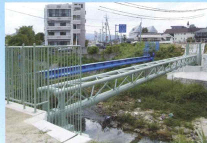
■水管橋 東広島市西条町田口 支間長:23.2m 送水管径:Φ350mm
