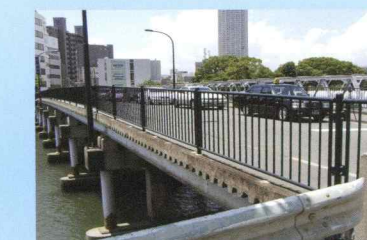
補修前 ■栄橋 広島市南区大須賀町
