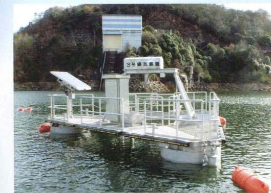
■浮遊設備型曝気装置 広島県世羅郡世羅町八田原ダム 浮体から湖底付近に配置された曝気設備より空気を上昇させます。
