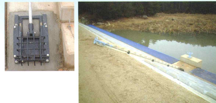
■斜樋・土砂吐ゲート・ため池栓 広島県世羅郡世羅町
