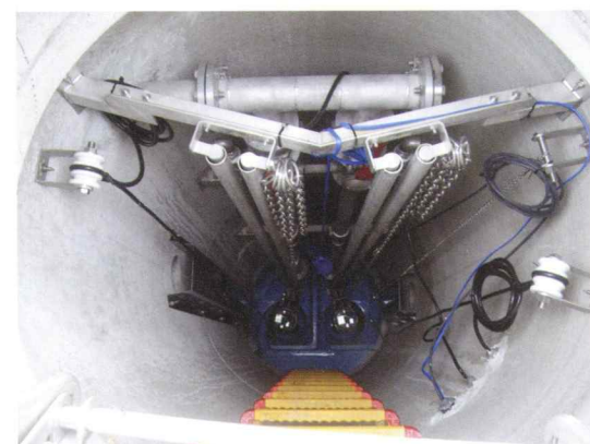
■マンホールポンプ 安芸高田市吉田町吉田
