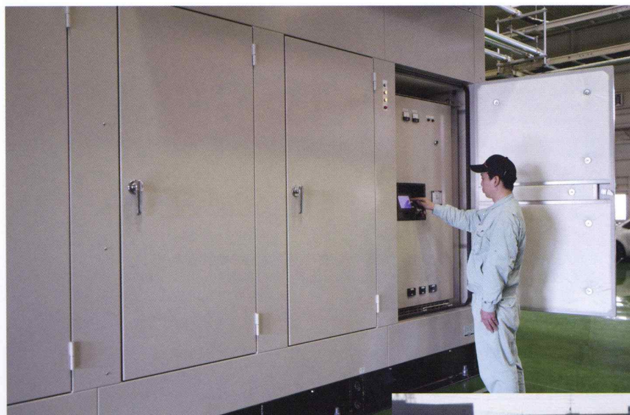
自家発電システム
