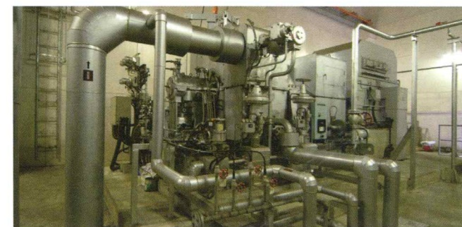
■発電タービンと発電機
