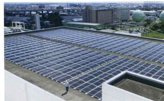
2021年9月 静岡工場生薬倉庫棟に設置された太陽光パネル
