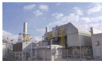
仙台工場に導入した天然ガスタービン設備
