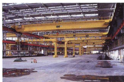
クレーン設備
