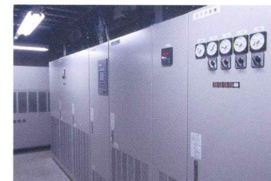
無停電電源装置
