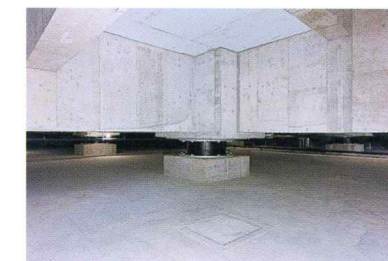
免震システム
