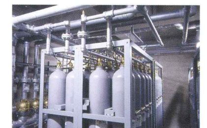
窒素ガス自動消火設備
