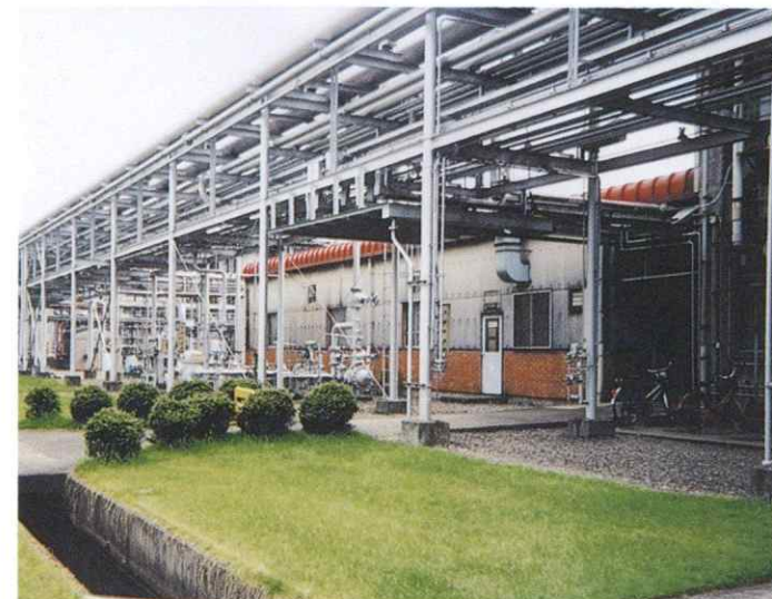
化学プラント輸送管
