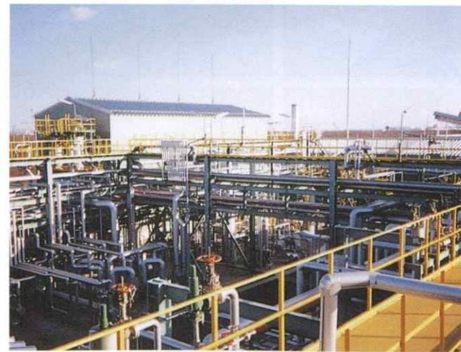
ガス、石油プラント
