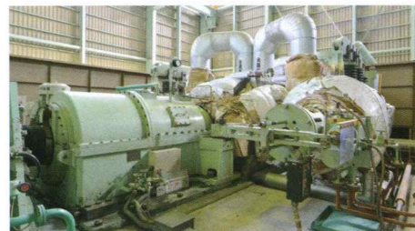
□ 蒸気タービン
