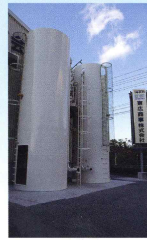
ジェットバック車受け入れ設備(ばいじんサイロ)
