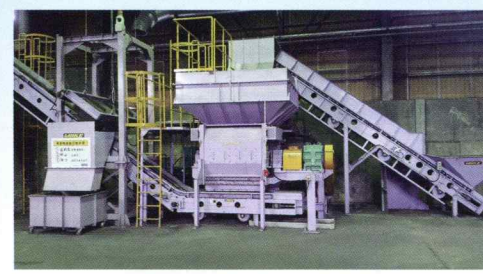
一軸破碎設備
