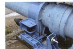
落橋防止装置
