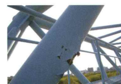
塗膜劣化状況
