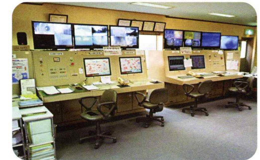
プラント運転室
