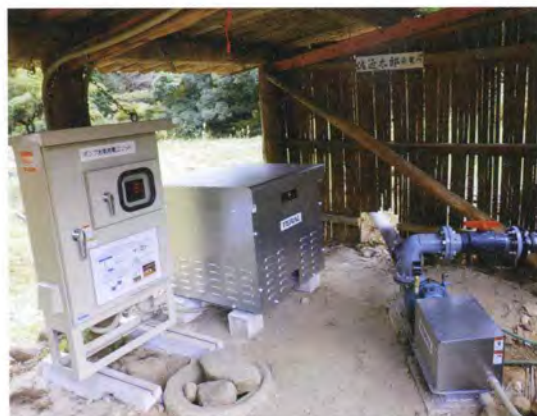
ポンプを利用した発電設備
