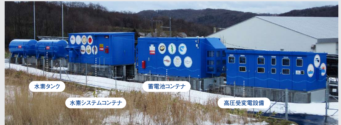
■ 石狩厚田 マイクログリッド施設 全景 (2021年12月撮影)
