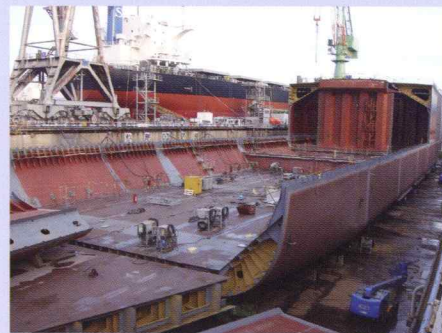
5号ドック (No.5 Dry dock) 長さ255m×幅50m
