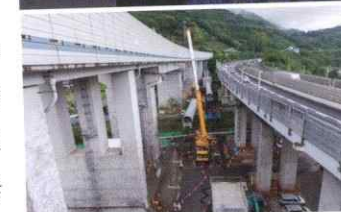
3次元データを活用した施工シミュレーション(上)と実際の施工の様子(下) 新東名高速道路川西工事(神奈川県足柄上郡)
