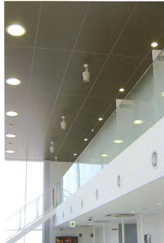
天井ファンによる冷暖房環境向上システム
