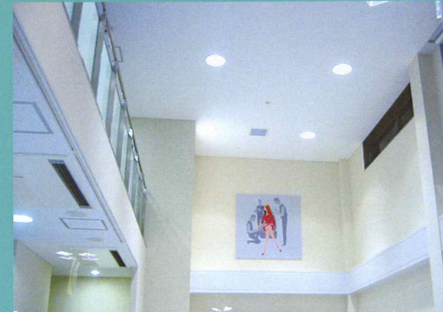
高効率反射板照明設備
