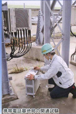
携帯電話基地局の開通試験
