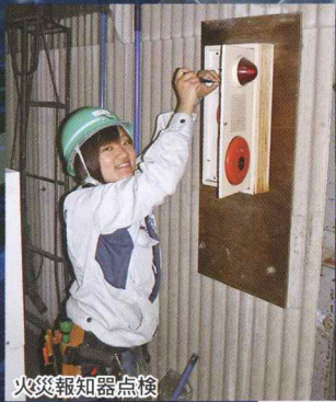
火災報知器点検
