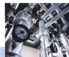
プラント配管
