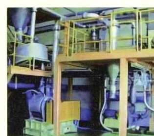
冷凍粉砕設備
