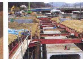
雨水排水函渠
