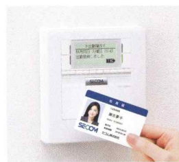
入退室管理システム
