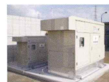
LPガス発電機54kVA 9.9kVAの2基
