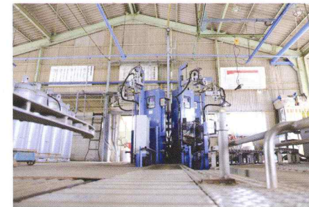
LPガス自動充填システム
