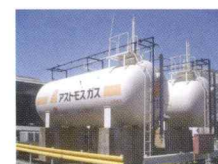
LPガス貯槽20t 15tの2基
