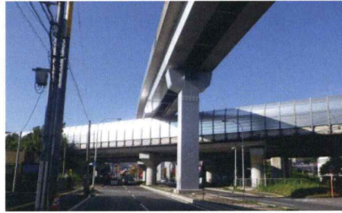
新交通1号線インフラ施設落橋防止装置
