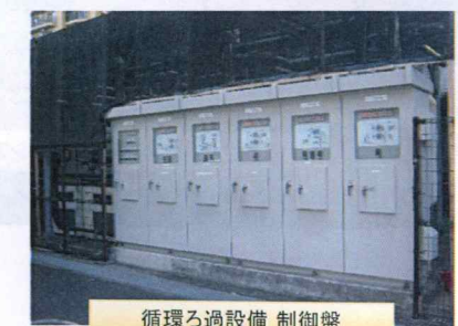
循環ろ過設備 制御盤
