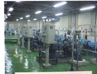
ポンプ設備を制御する操作盤
