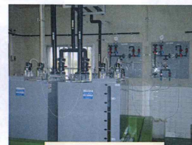
薬品注入設備
