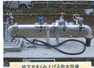
地下水をくみ上げる取水設備
