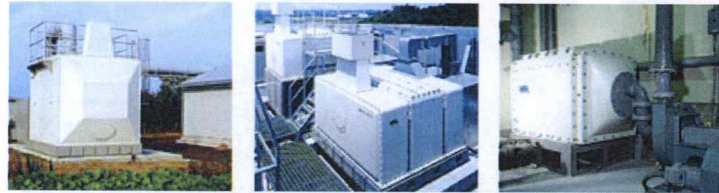
各種施設に導入されている横型吸着装置
