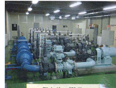
配水ポンプ設備
