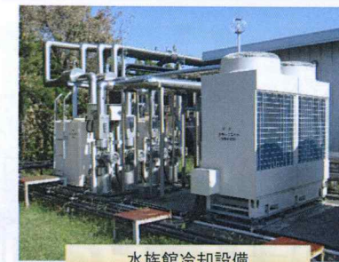
水族館冷却設備
