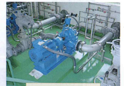
ろ過ポンプ設備
