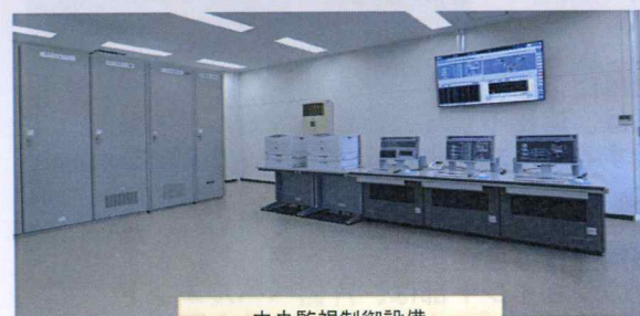
中央監視制御設備
