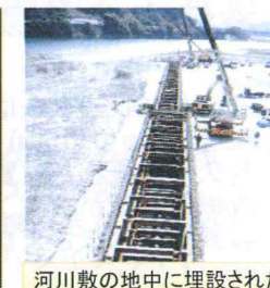
河川敷の地中に埋設されたスクリーン
