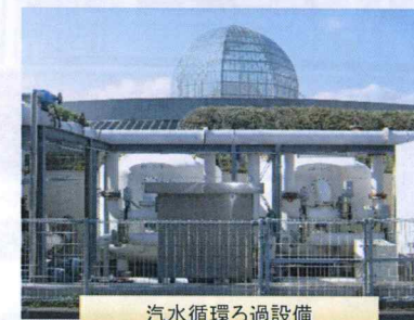
汽水循環ろ過設備
