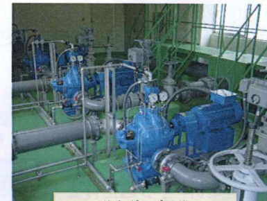
送水ポンプ設備
