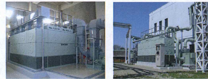
下水処理施設に導入されている横型生物脱臭装置
