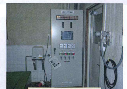
次亜注入機制御盤
