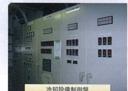
冷却設備制御盤
