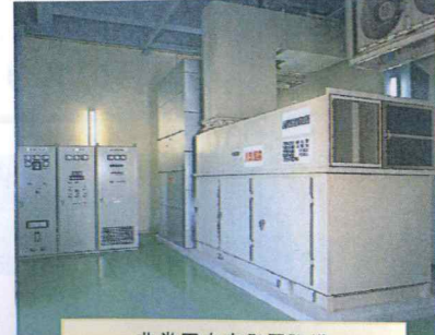
非常用自家発電設備
