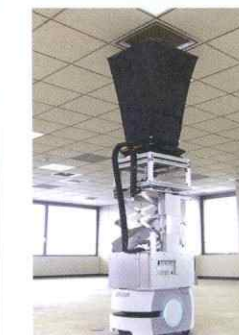
自律走行型ロボットによる風量測定
