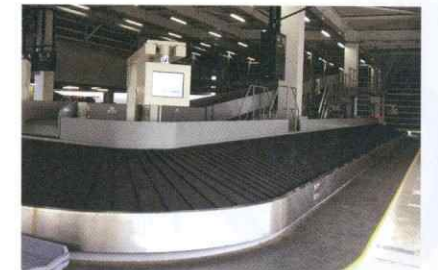
新たに納入した搬送設備「メイクアップ」
