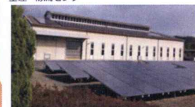
太陽光発電設備
