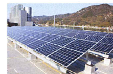
太陽光発電パネル (当社屋上)
