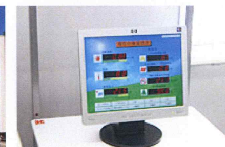
太陽光発電計測監視装置
