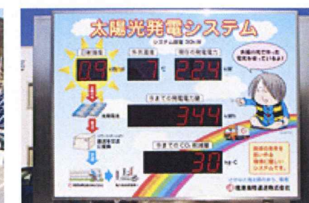
太陽光発電状況表示板
