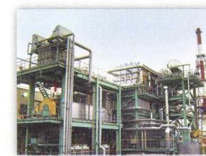
八潮工場バイオマス焼却発電設備
