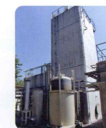
メタン発酵設備
