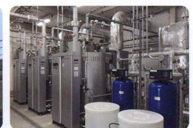
ガスボイラー室
