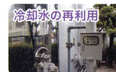
冷却水の再利用 設備の冷却などに使用した水を過し紫外線殺菌した後に清掃水などに再利用します。
