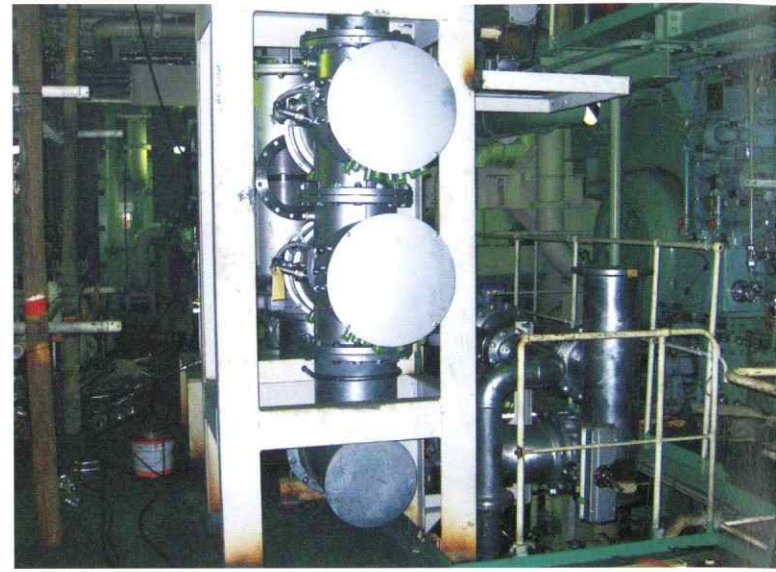
バラスト水処理装置設置工事 Retrofit of Ballast water management system
