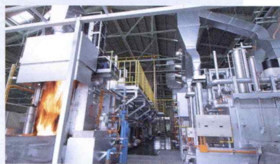
連続浸炭炉 Carburizing Furnace
