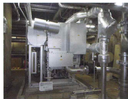
空調蒸気吸収式冷凍機
