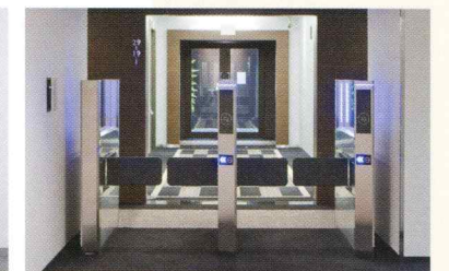
入退室管理システム
