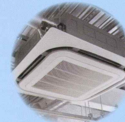
空調・換気設備
