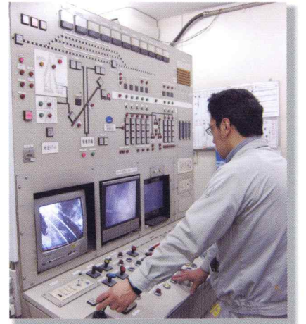
▲破碎棟 オペレータ室
