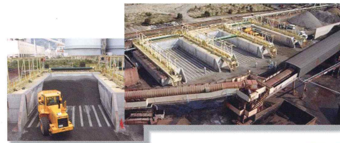
▼蒸気エージング設備
