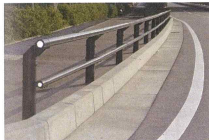
ガードパイプ
