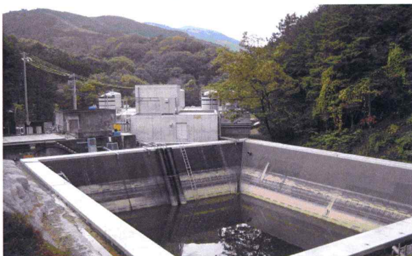
水処理施設状況
