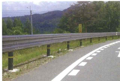
ガードレール
