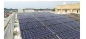
屋上太陽光発電設置事例
