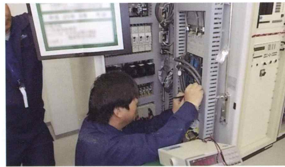
◆多目的衛星地球局の制御装置の点検
