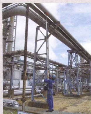
ラック上の保温配管の測定風景
