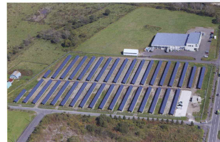
白老第一発電所(日本ハウスウッドワークス北海道工場敷地内)(メガソーラー事業)
