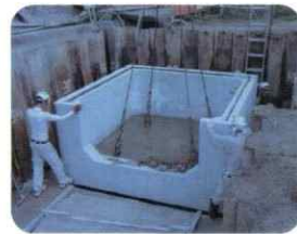
大型の集水槽
