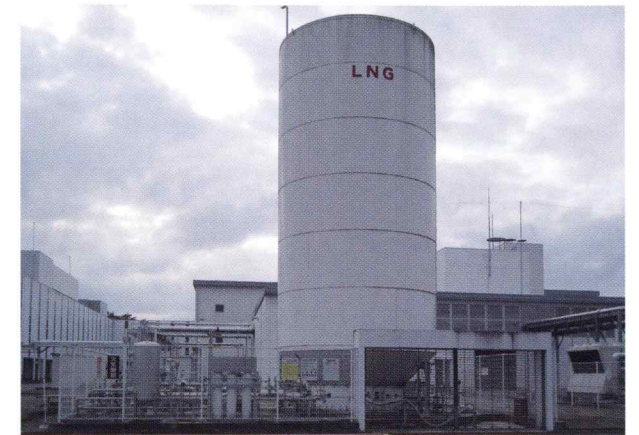
液化天然ガス(LNG)貯蔵タンク
