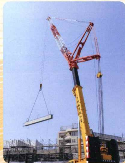
三木町病院建屋建築工事 360t吊クレーン（ラフィングジブ仕様）にて梁（はり）の揚重作業
