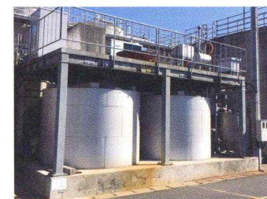
下関工場のバイオガス発電設備
