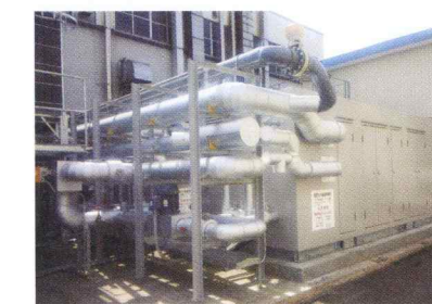
ニチロ畜産(株)札幌工場 ノンフロン冷凍機
