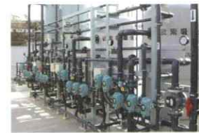
ろ過・吸着処理装置
