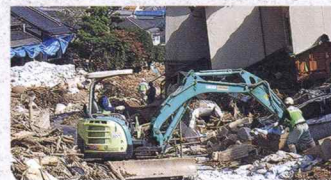
▲2018(平成30年) 西日本豪雨災害復旧工事 (広島市・坂町・府中町・海田町)
